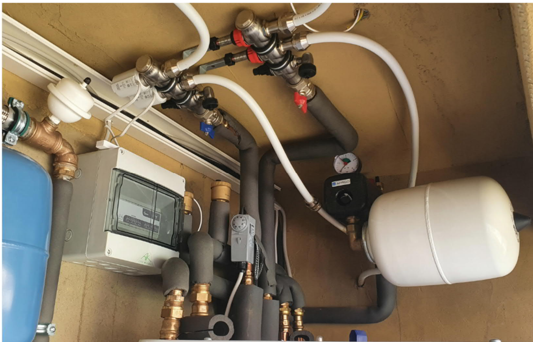
Abbildung 9: Verrohrung Wärme-/Kältekreislauf incl. Ausdehnungsgefäßen für Decken- bzw. Wandheizung und Kühlung nach Fertigstellung
