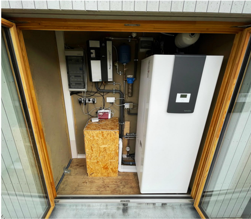
Abbildung 8: Technikraum mit Kombieinheit Wärmepumpe / Pufferspeicher, Elektroverteiler und Regenwassermanagement nach Fertigstellung
