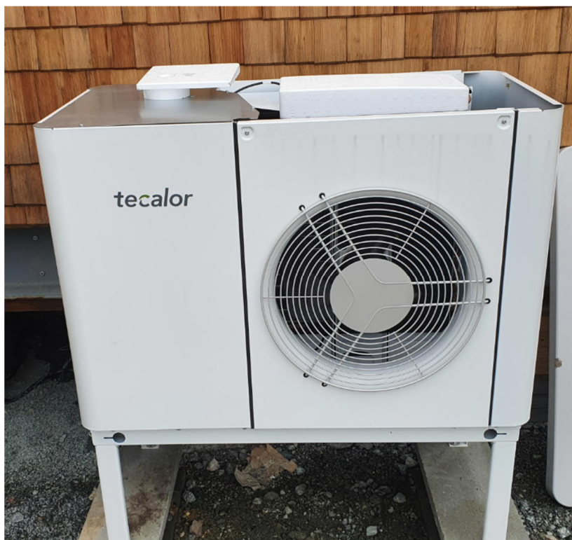
Abbildung 10: Außeneinheit Verdampfer Wärmepumpe (Rückseite Gebäude)
