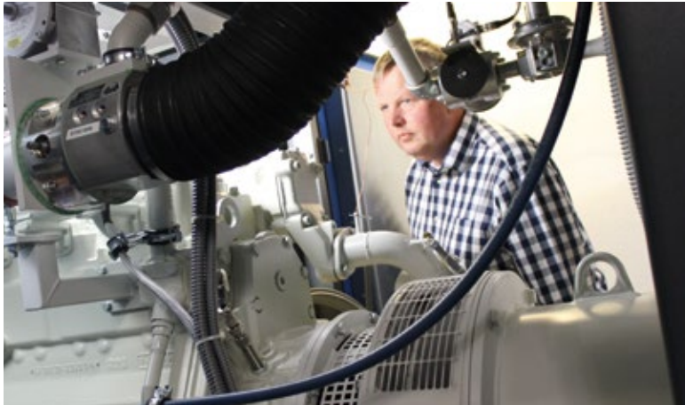
Frank Nossol am Blockheizkraftwerk
